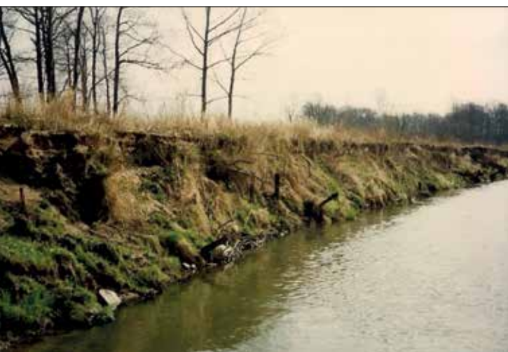
Fot. 1 i 2. Zerodowane brzegi rzeki
